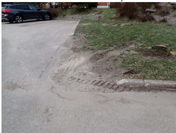
13. Reunakivetyksiä on liikkunut paikoiltaan
