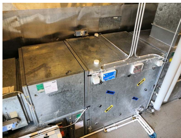
82. Ilmanvaihtokone TK204 on mallia Fläkt.
