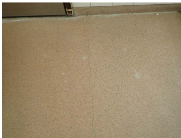
63. Lattiapintoja sisätiloissa. Halkeama keittiön epoksipinnoitteessa
