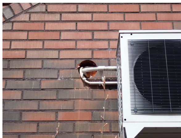
32. Ulkoseinässä oleva läpivienti tulee tiivistää.
