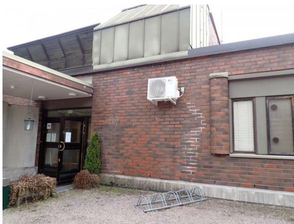
31. Ulkoseinässä oleva kalkkihärmä saattaa johtua ilmalämpöpumpun valumavesistä. Varmistetaan, että vedet ohjautuvat etäälle julkisivusta.
