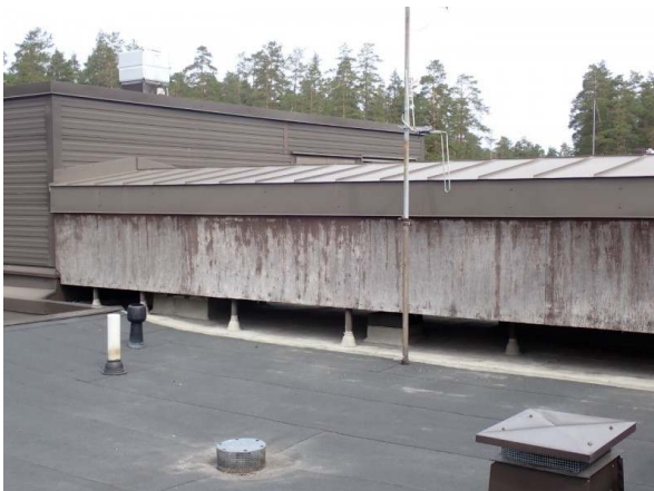
50. Vesikatolla on peitelevyistä kulunut maalipinta
