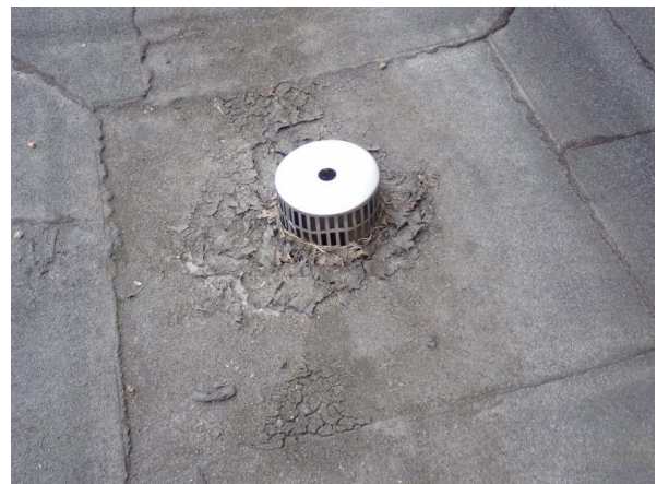
2. Sadevesikaivot tulee pitää puhtaina
