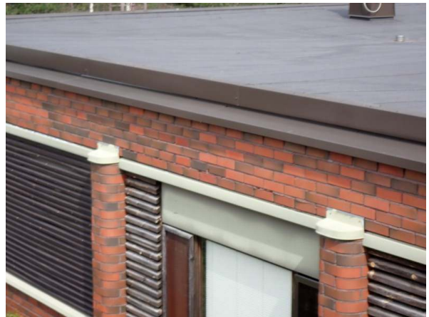
34. Tiilisaumojen väri-laasti on paikoin irronnut
