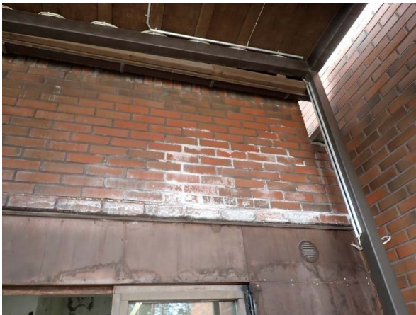
33. Ulkoseinässä olevaa kalkkihärmää teknisen tilan läheisyydessä. Tarkastetaan aiheuttaja.
