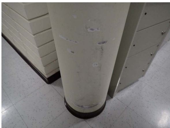
62. Pilarin maalipinnat ovat kuluneet
