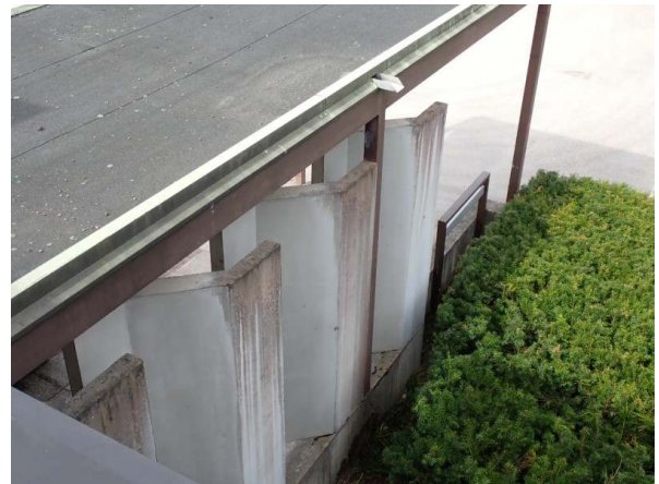
18. Katoksessa on puhdistustarvetta
