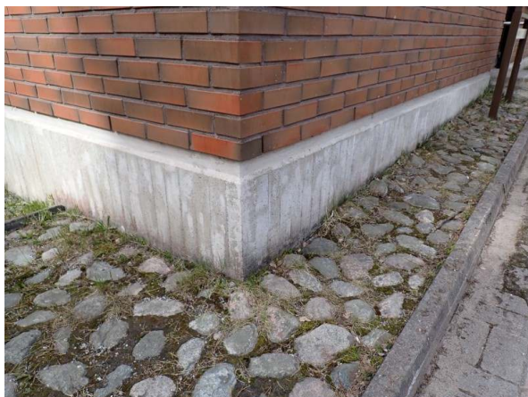
25. Sokkeleiden betonipintoja ei ole käsitelty
