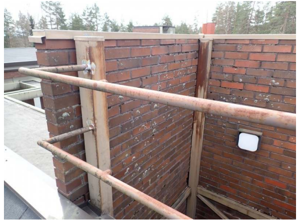
22. Katolle johtavien metalliportaiden kaiteet ovat ruosteessa ja alaosassa olevassa sokkelirakenteessa on vaurioituneita teräksiä
