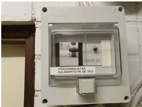
123. Oven edustan lämmityksen termostaatti.
