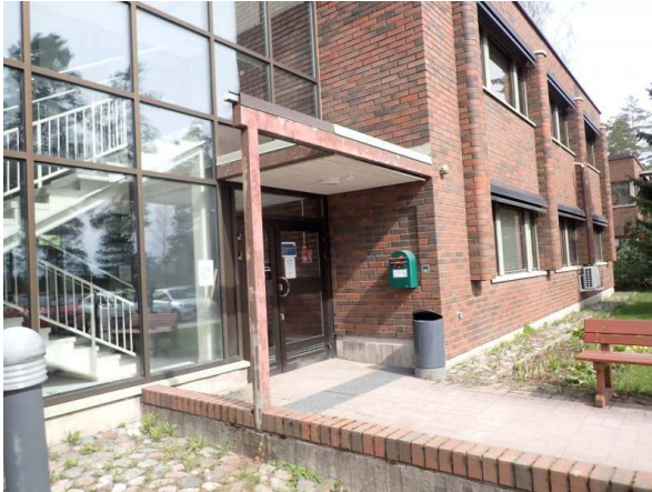
15. Katoksen metalliosien maalipintaa on osin irronnut niiden pinnoilta
