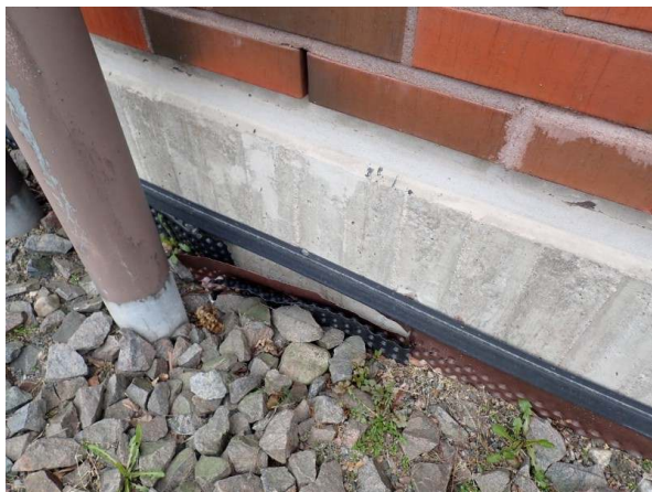
29. Patolevy on rikkoontunut yläreunan alapuolelta. Korjaaminen.
