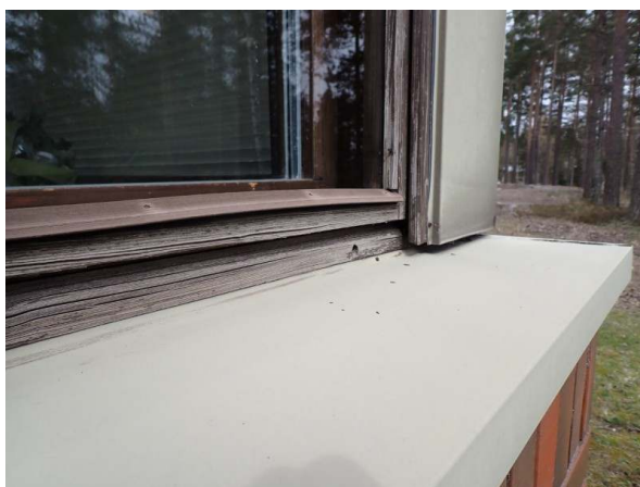
39. Puupuitteissa on jonkin verran vaurioita
